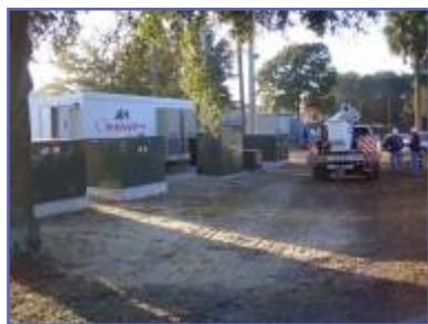
2MVA 26kV AVC Bacardi. USA
