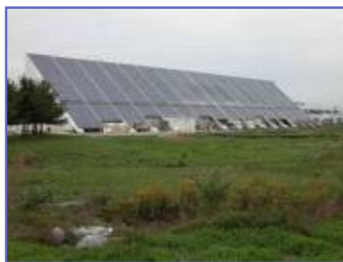
1500kVA + 750kVA AVC BP Solar. USA
